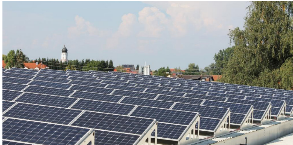
Mit Solaranlagen, der Abwärmenutzung eines BHKW auf dem Betriebsgelände, das mit dem Biogas eines Landwirts betrieben wird, und einer Absorptionskälteanlage produziert die Druckerei Mayer & Söhne klimaneutral. Bild: Mayer & Söhne
